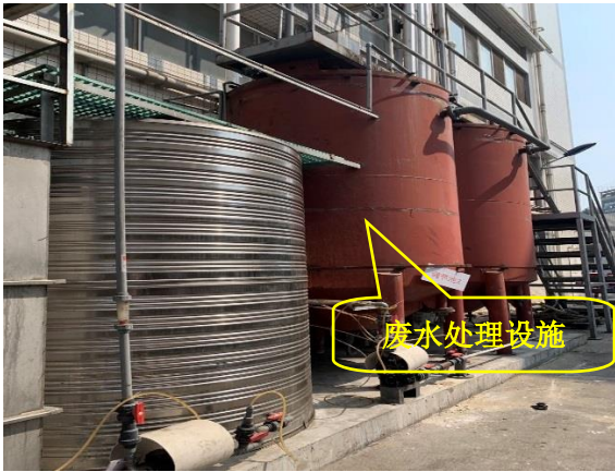
项目废水处理设施
