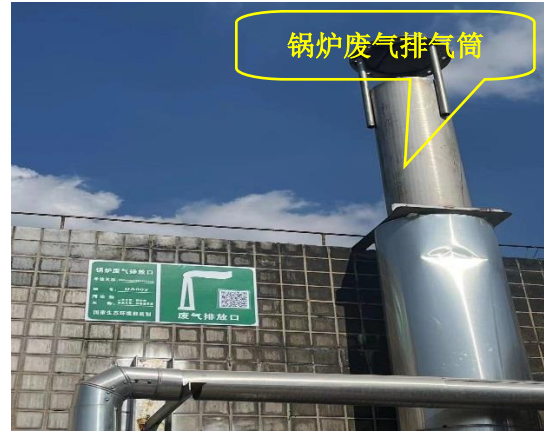
锅炉废气排气筒
