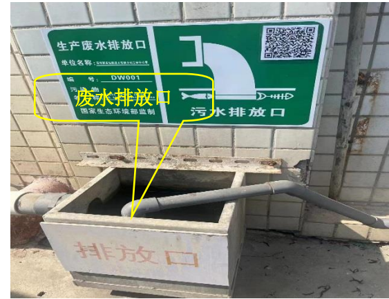
项目废水排放口
